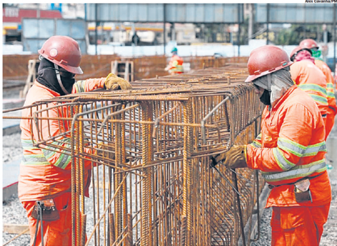
MOBILIDADE. Construção do Complexo Viário Santa Teresinha, estima reduzir tempo de viagem em 300%
