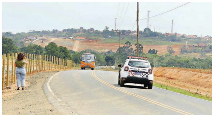
Em Monte Mor, as obras da Estrada do Rio Acima (MOR 354), via de acesso da cidade até o Aeroporto Internacional de Viracopos, estão quase concluídas
