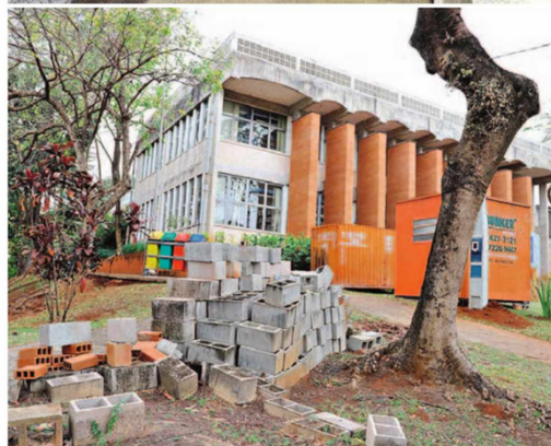
Na Unicamp, enquanto a construção do sanitário para Pessoas com Deficiência (PCD) foi finalizada (foto de cima), as obras de acessibilidade do prédio dos professores do IFCH estão paradas, aguardando assinatura de novo contrato
