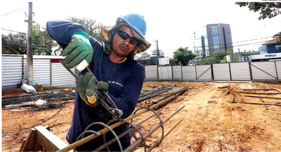
O armador Rojane Souza Santos comemora ter conseguido emprego: “Agora posso voltar a sonhar com alguma coisa”, afirmou, enquanto montava estruturas de ferro em uma obra
