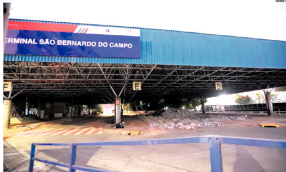
COMEÇO. Terminal em S.Bernardo foi o primeiro local a receber intervenções para construção do BRT
