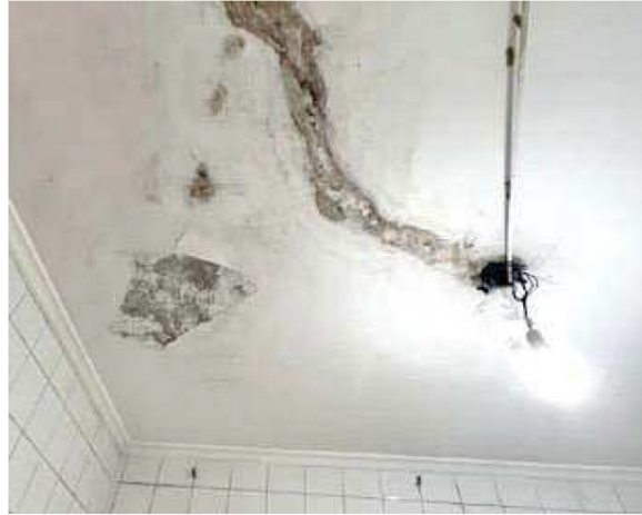
Prédio da Câmara de Cubatão está repleto de problemas estruturais desde o ano de 1976
