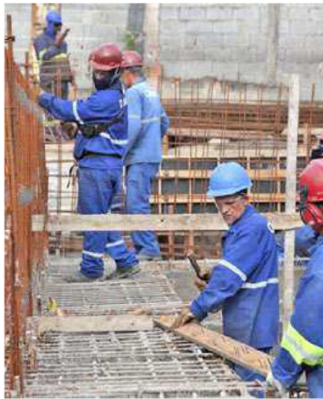
O sistema contra enchentes do programa de macrodrenagem Santos Novos Tempos entrará em funcionamento em janeiro
