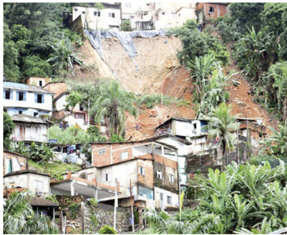
Famílias santistas foram retiradas há dois anos por conta dos deslizamentos após fortes chuvas
