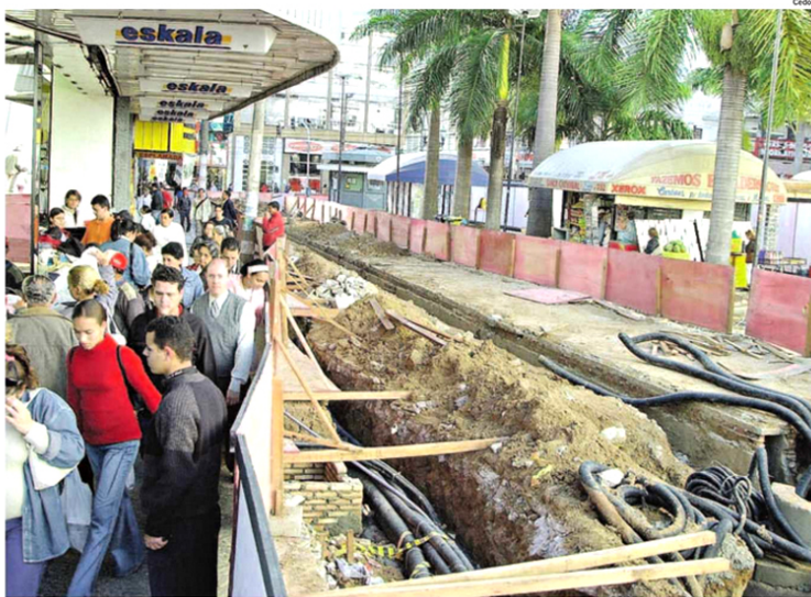
Nas obras da Rua 13 de Maio em 2003, todos os cabos de energia elétrica foram enterrados sob o calçadão, para remover a fiação que ficava suspensa
