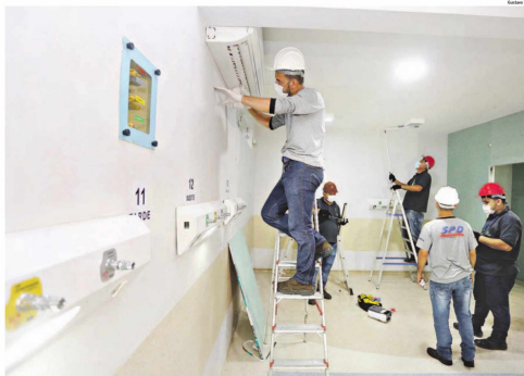
Trabalhadores executam obras no novo Hospital Mário Gattinho, sob fiscalização do novo Hospital Mário Gattinho, sob fiscalização dos profissionais e intimação de crianças
