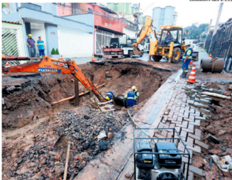
PERDAS. Rompimento de adutora já causou transtorno em Sto. André
