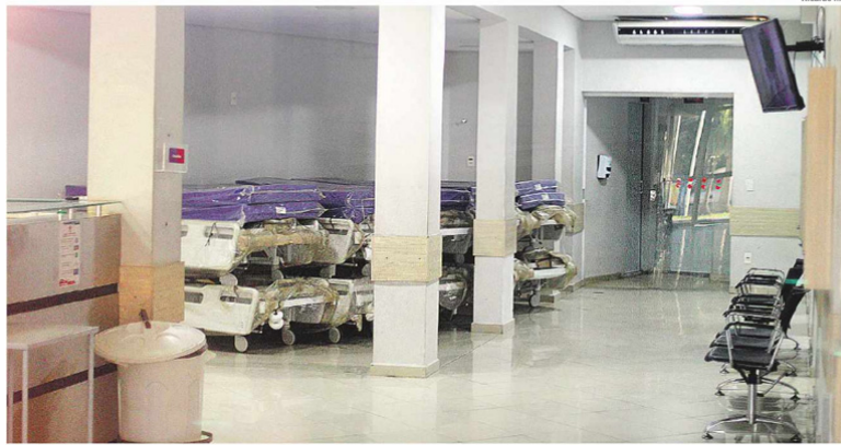
Prédio onde será instalado o futuro hospital pediátrico "Mário Gattinho", com verba prevista de R$ 38,9 milhões dos cofres municipais
