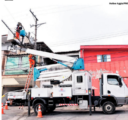
MODERNIZAÇÃO. Santo André tem 38,2% da rede iluminada por LED
