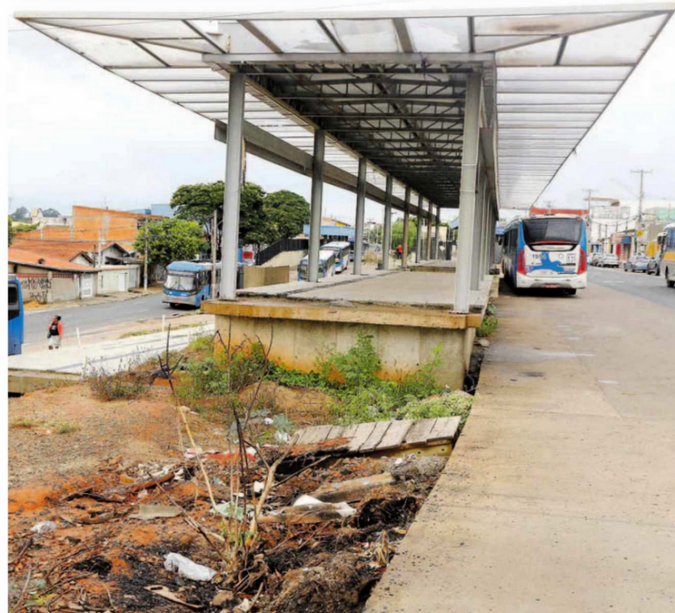
Trechos viários e passeios perto dos terminais de ônibus ainda não foram finalizados devido ao não cumprimento do contrato pela construtora
