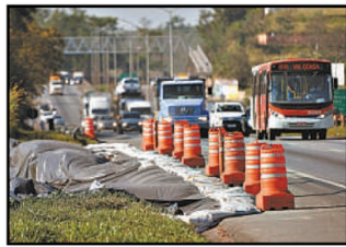
Uma lama ainda tenta segurar deslizamento de terra no margem provocado pelas chuvas e ainda sem solução no Km 509 da BR-040
