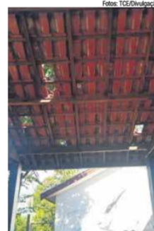
Telhado danificado foi outro problema achado na unidade
