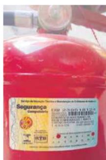
Extintor vencido foi achado na Emef Cônego Aníbal Difrância
