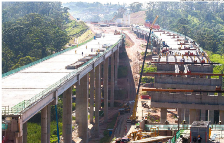
O trecho Norte do Rodoanel Mario Covas tinha previsão de entrega em 2014, porém segue com as obras paradas desde dezembro de 2018
