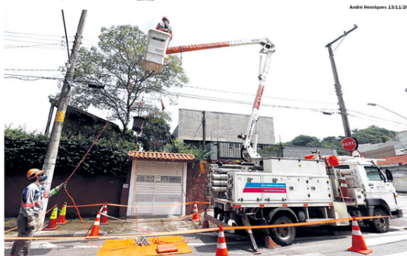
FREQUÊNCIA. Reclamações sobre interrupção no fornecimento de energia têm sido constantes na região
