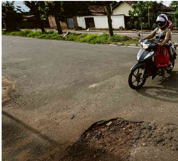
Buraco em via recém asfaltada com verba da Codevasf em Araguatins (TO) Foto: Adriano Vazini/Folhapress
