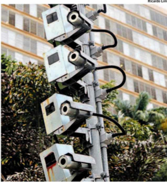
Conjunto de radares instalados em frente ao Palácio dos Jequitibás
