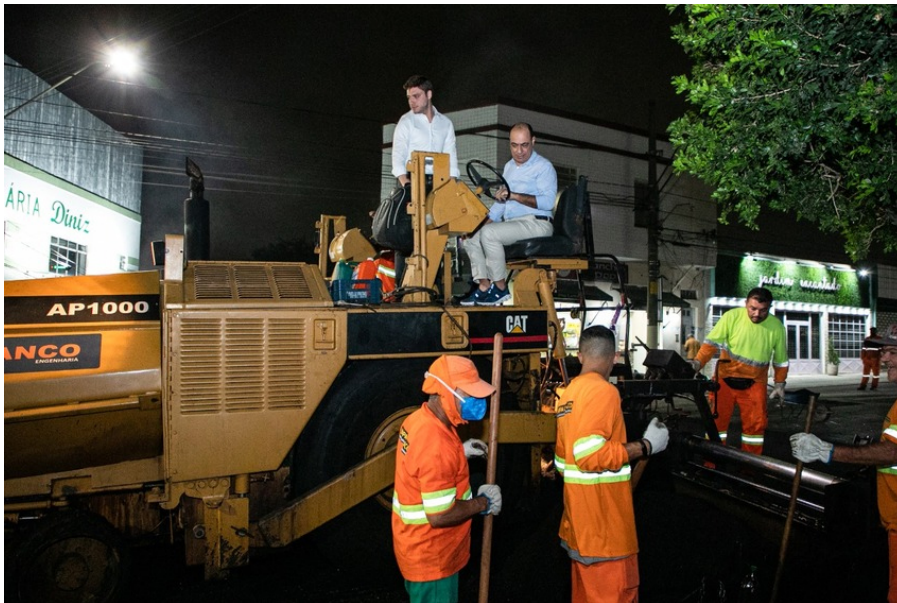
Prefeito Auricchio vistoria obras que serão concluídas até o fim de abril
