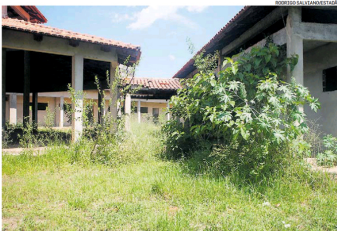
Em Inhumas, Goiás, mato tomou conta da área onde começou a ser construída uma escola; obra parou
