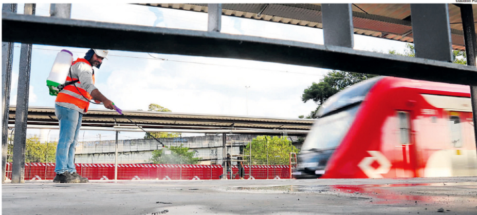
RITMO ACELERADO NA OBRA. Operários da CPTM trabalham para modernizar a Estação Capuava; piso das plataformas e telhado estão sendo reformados
