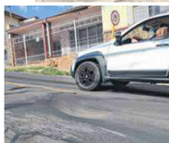
Quadra 2 da rua Floresta mostra exemplo de buraco camuflado com asfalto
