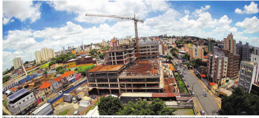
Obra do Hospital São Luiz, no espaço das Avenidas Andrade Neves e Barão de Itaipua, encontram-se em fase avançada e a previsão é que a inauguração ocorra dentro de um ano.
