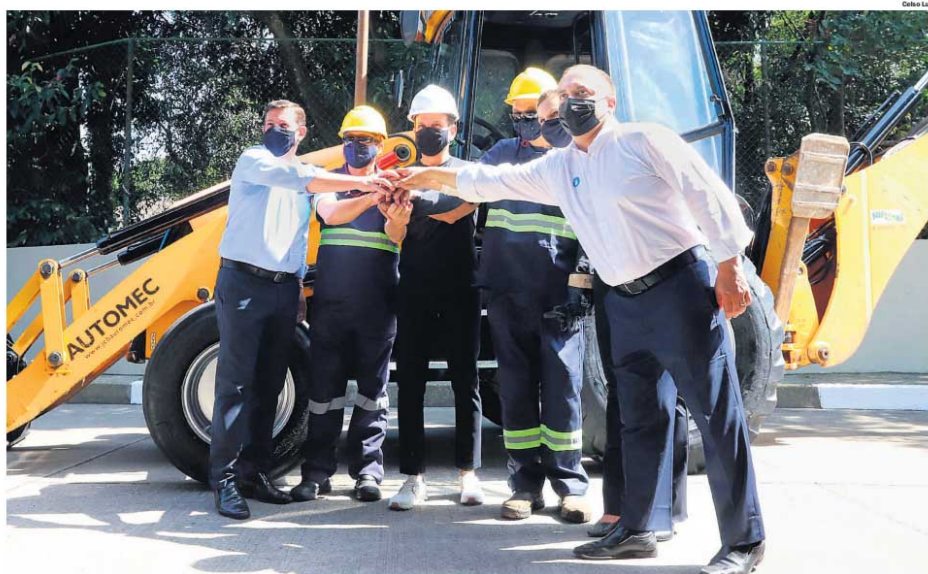
LARGADA. Governador João Doria, prefeito Orlando Morando e o vice Marcelo Lima participaram da solenidade que marcou o início da construção do BRT-ABC
