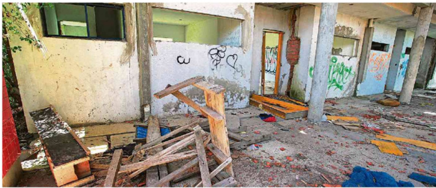
Grau de destruição e abandono na Moradas da Hípica, zona sul da Capital, para quem vê, torna difícil crer em aproveitamento do que foi construído
