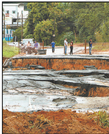
DESTRUIÇÃO EM SEQUÊNCIA EM verificações ao menos quatro erosões no caminho da BR-262, que liga Monlevade ao Abre Campo, nas proximidades dos desvios e, em Rio Casca (acima), o asfalto é desmanchado
