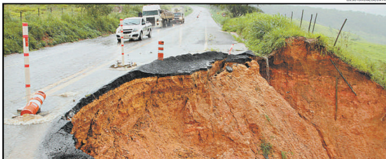
PISTA DESAPARECE Uma das regiões mais afetadas pelos estragos na BR-262, em Rio Casca parte da estrada cedeu e ficou submetida ao impacto continuado das chuvas e da lama que escorre
