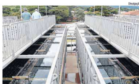
Direção do DAE visitou a ETA da cidade de Cabreúva, equipamento igual ao que o DAE pretende instalar aqui
