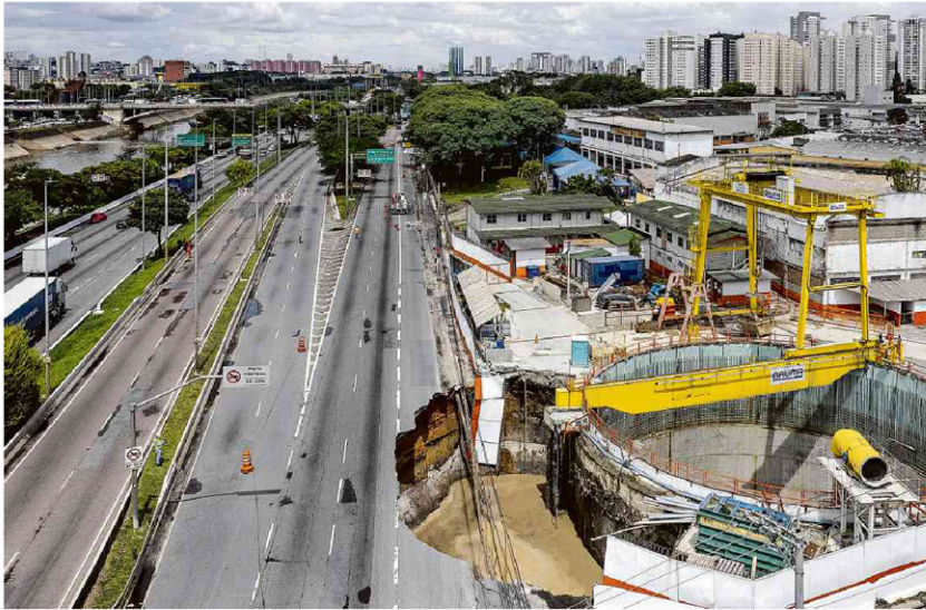
A cratera aberta na marginal Tietê, que interditou acesso a rodovias e provocou grandes congestionamentos na capital paulista. Eduardo Knapp/Folhapress
