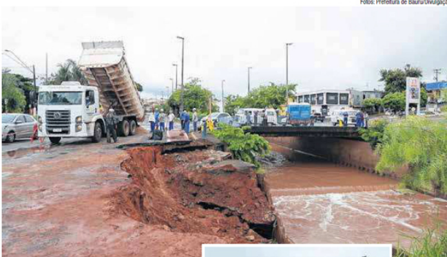
Paliativo: equipe da Obras realizou a contenção da erosão na Nuno de Assis nesta segunda-feira
