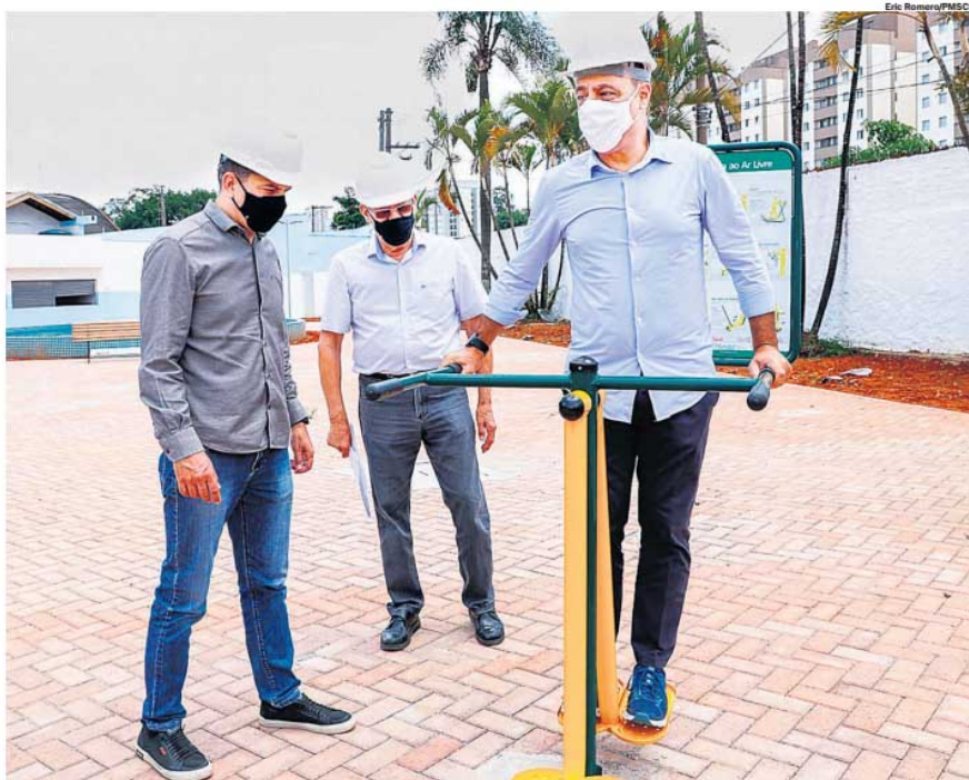
VISITA. Auricchio visitou as obras do Cise do bairro Fundação e prometeu que equipamento estará pronto em junho
