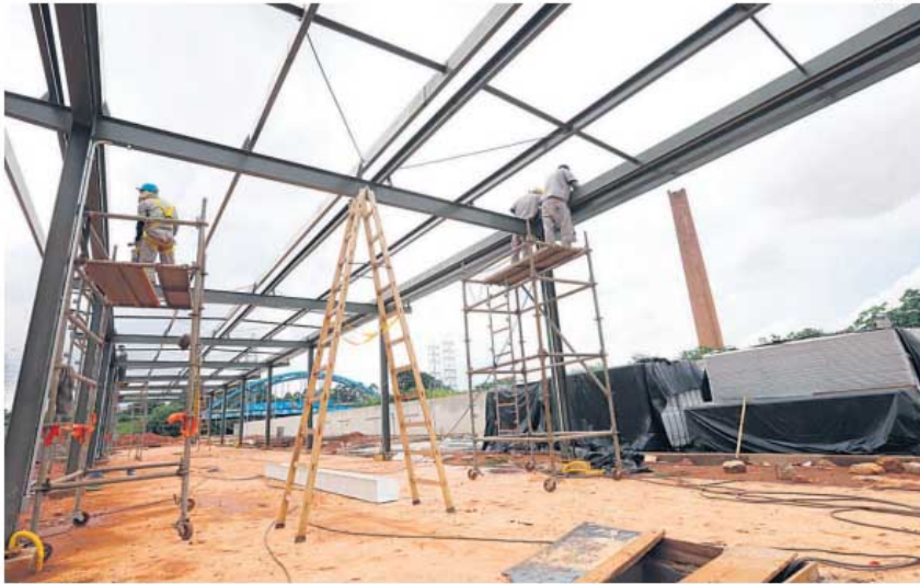
EM OBRAS. Operários trabalham em ritmo acelerado para concluir espaço de lazer no prazo estimado
