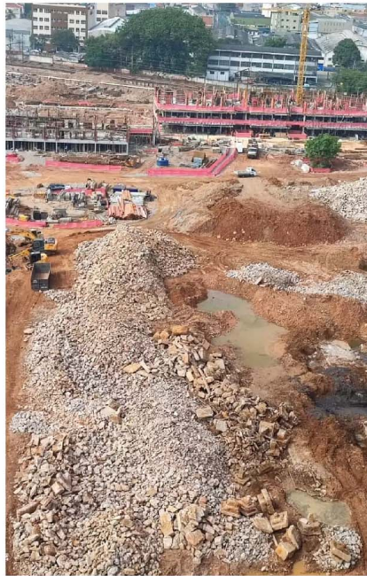
Obras do lote 1 do empreendimento Reserva São Caetano é paralisada devido a vazamento de produto químico ainda não identificado
