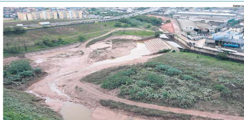
EM MAUÁ. Piscinão RT-3 Petrobras, segundo a SP Águas, chegou a entrar em estado de alerta
