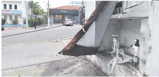
SANTO ANDRÉ. Estabelecimento localizado na Avenida Padre Manoel de Nóbrega, no Centro, apresenta indícios de violação, como grade danificada e ausência do equipamento
