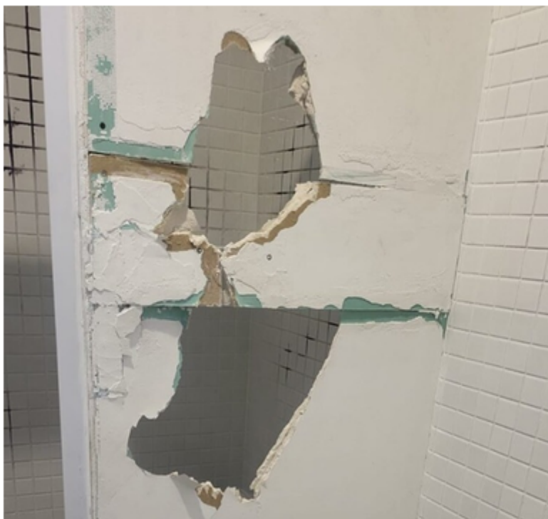
Banheiro teve parede interna completamente destruída (Foto: Divulgação)
