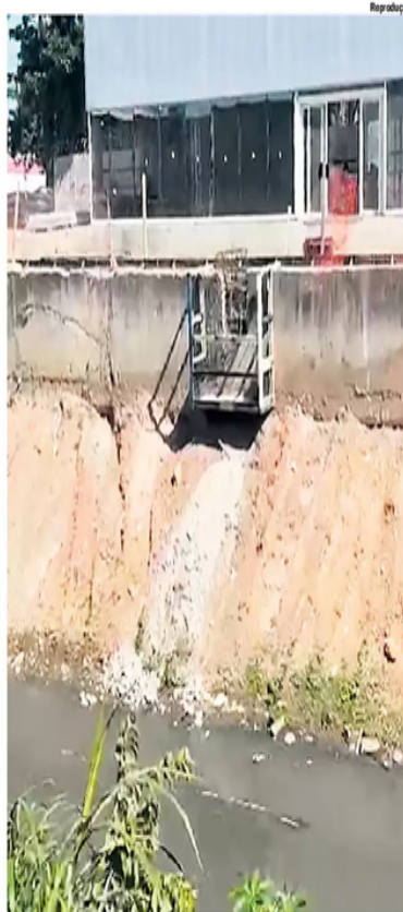
IRREGULAR. Terra é depositada no leito do ribeirão ao longo de obra
