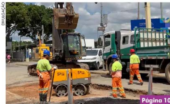
Obras avançam nas ruas Ceará, Amazonas e avenida dos Estados, com redes, reservatório e interligação ao piscinão
