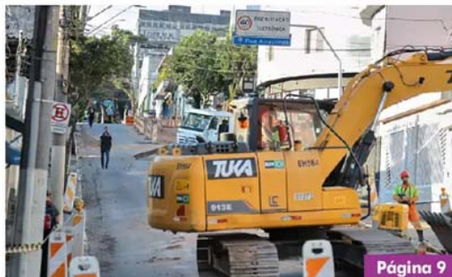
Novo trecho entre as avenidas Paraíso e Fernando Simonsen recebe 60 metros de rede para ampliar o sistema de drenagem
