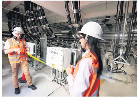
ALTO DESEMPENHO. Subestação implantada em São Caetano integra o novo sistema de transmissão
