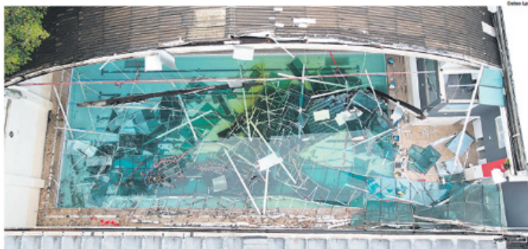
DESTRUIÇÃO. Vista aérea da academia Inova, em São Caetano, cujo teto desabou ontem, após temporal que atingiu município
