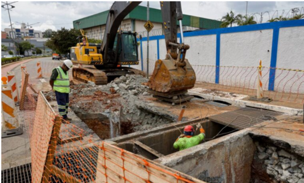
Obras do Drenar São Caetano nas avenidas Fernando Simonsen e Nelson Braido entram na fase final – Foto: Eric Romero / PMSCS
