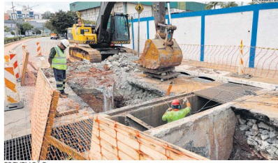
PREVENÇÃO. Intervenções do Drenar são voltadas ao combate às enchentes na cidade são-caetanesa
