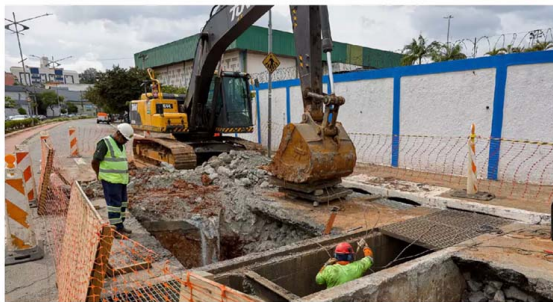
Um mês de 1,4 km de novas redes de drenagem e esgoto, as intervenções no cruzamento Fernando Simonsen e Nelson Braidó abrigam o sistema de captação e escoamento de águas plúvias, conectando-se ao Ribeirão dos Meninos.
