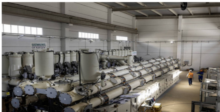
Subestação de energia da empresa ISA em São Caetano (SP) - Eduardo Knapp - 20.jul.25/ Folhapress
