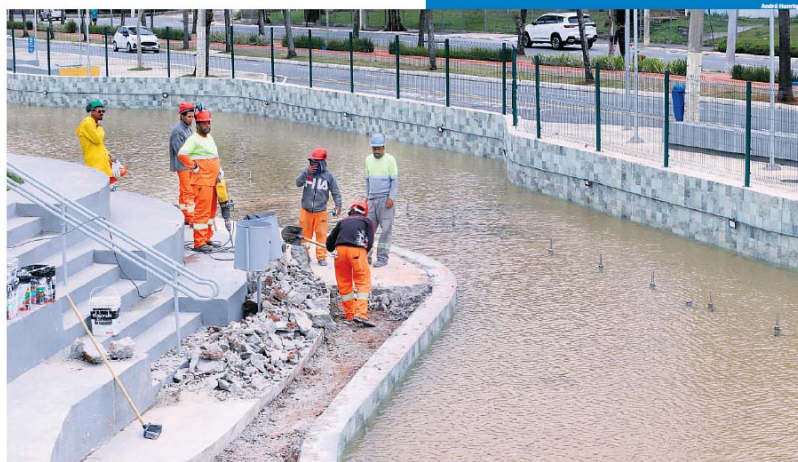
DANIFICADO PELA CHUVA
