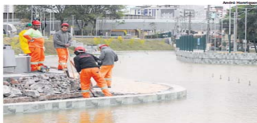
ESTRAGOS. Funcionários de terceirizada atuam no equipamento
