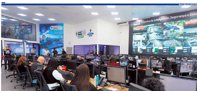
CENTRO DE INTELIGÊNCIA. Ampliação do sistema prevê a instalação de cinco servidores de armazenamento e sete estações de trabalho
