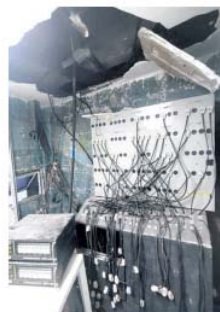
FIAÇÃO. Exposta no Cacilda
