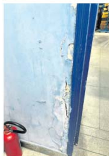
GINÁSIO. Danos em parede
