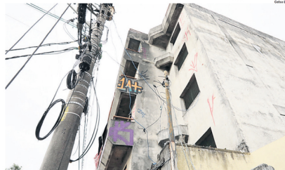
FURTO. É possível observar fio instalado irregularmente em imóvel invadido em área nobre de São Caetano
